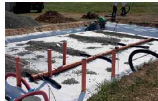
Instalace odvětrání radonu
